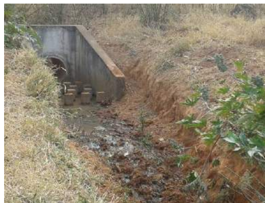
Figura 103 - Lançamento de água pluvial contaminado com chorume oriundo do pátio de compostagem sobre área permeável.
