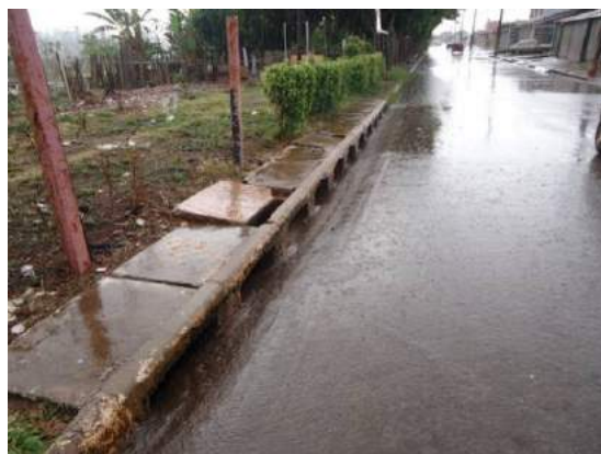
Figura 89 - Boca de lobo da rede de drenagem da Via P Cinco.
