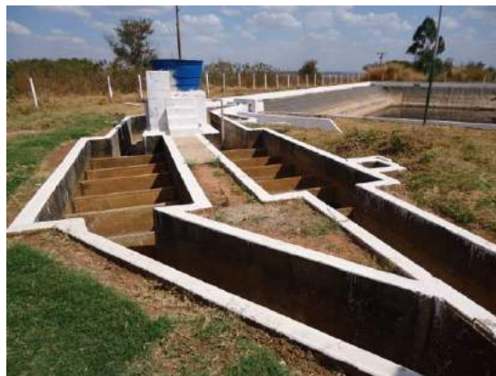
Figura 70 - Sistema de tratamento do chorume.
