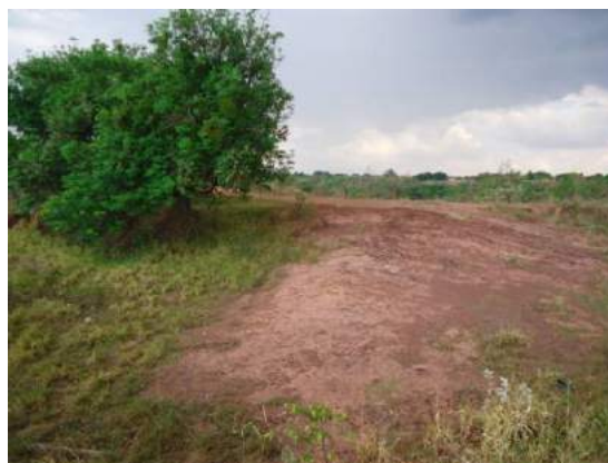
Figura 76 - Berma na linha de ruptura com necessidade de manutenção.
