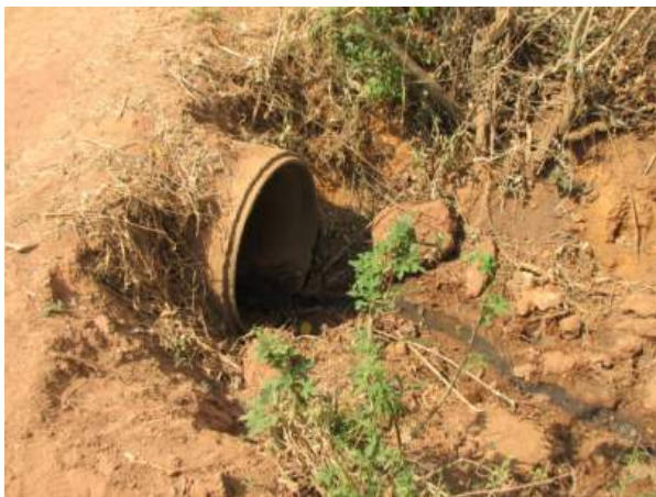
Figura 118 – 1ª Tubulação de águas pluviais conduzindo chorume.
