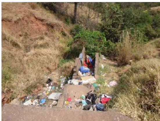
Figura 150 - Resíduos sólidos dispostos nas proximidades de estrutura de drenagem superficial desativada.
