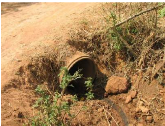
Figura 95 - Saída de água pluvial do lavador de caminhões da UCTL – Ponto 2.
