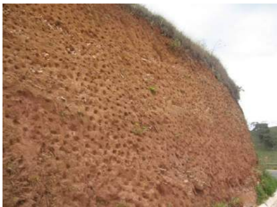
Figura 154 - A foto demonstra o aspecto do microcoveamento em um talude de corte.
