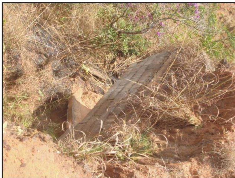
Figura 83 – Destroços de estruturas de drenagens anteriormente existentes.
