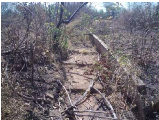
Figura 75 - Descida d'água danificada.
