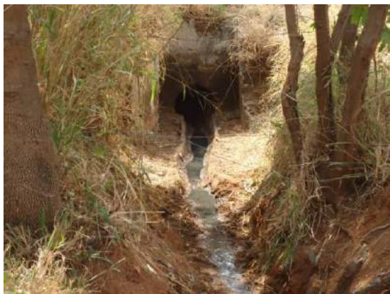
Figura 71 - Lançamento de efluente em áreas permeáveis.
