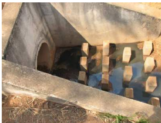
Figura 96 - Dissipador de energia da saída de água pluvial do lavador de caminhões da UCTL.
