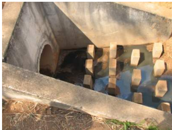
Figura 119 – 2ª Tubulação de águas pluviais conduzindo chorume.
