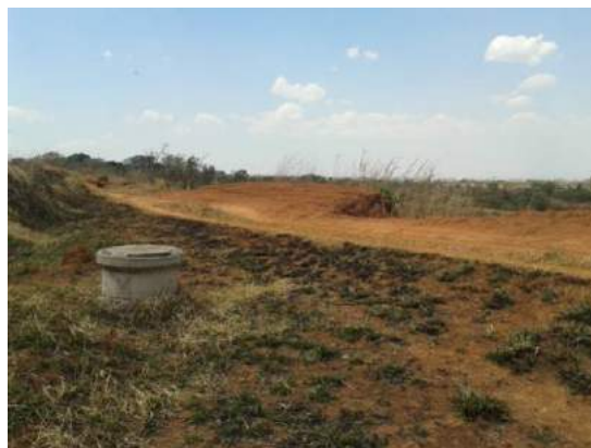
Figura 92 – Poço de visita da rede de água pluvial.
