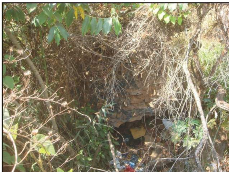
Figura 84 – Muro construído na linha do talvegue da erosão para conter a energia da água, foi erodido na base e desestabilizado.
